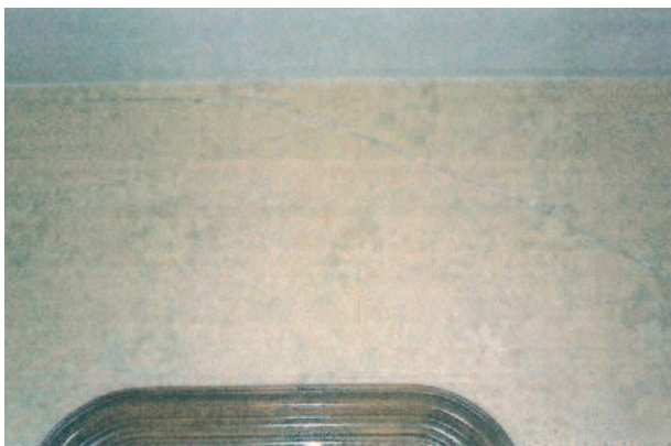
Fissuration intérieure, tapisserie déchirée - Maison André.
